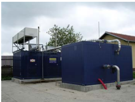
Figure 11 – Petruvky, CZ, TEDOM Cento T 300 SP 300 kWe, 370 kWt Puc. 11 – Petruvky, CZ, TEDOM Cento T 300 SP 300 kWe, 370 kWt Слика 11 – Petruvky, CZ, TEDOM Cento T 300 SP 300 kWe, 370 kWt
