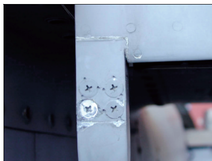
Slika 14 – Galvanska korozija na MB-339 između nosača od Mg legure i zavrtnja od aluminijuma Рус. 14 – Гальваническая коррозия на MB-339 между опорой из Mg сплава и алюминиевыми заклепками Figure 14 – Galvanic corrosion on the MB-339 between an Mg alloy trim and aluminum rivets
